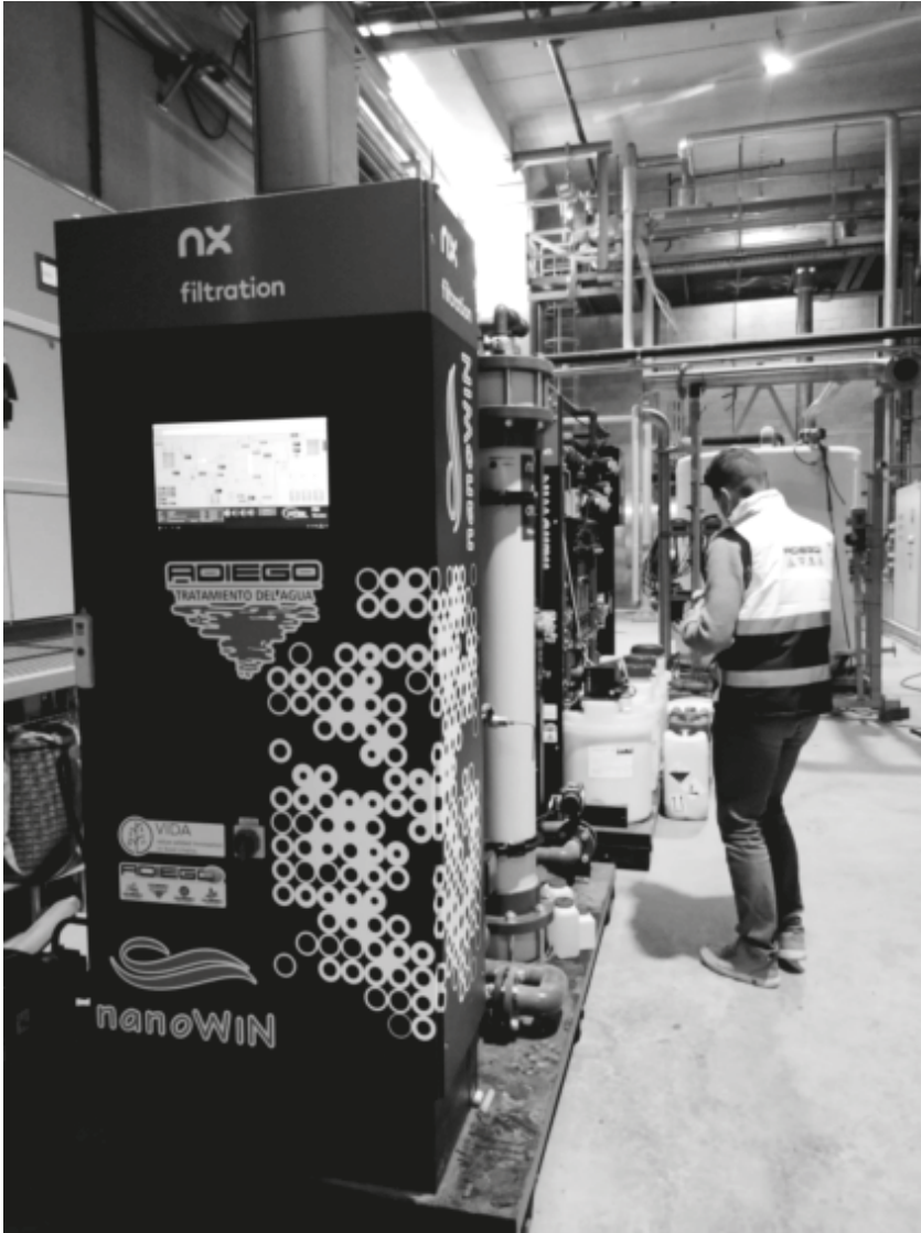
Figura 5. Planta de tratamiento de nanofiltración, NANOWIN.
