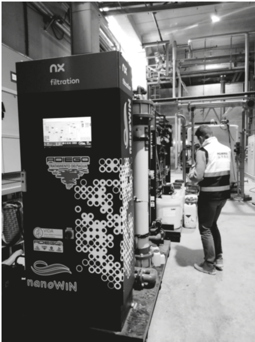
Figura 5. Planta de tratamiento de nanofiltración, NANOWIN.
